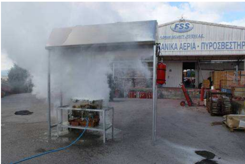
Εικόνα 10. Στιγμαία κατάσβεση πυρκαγιάς μέσα από τα μπεκ κατόπιν διάρρηξης του σωληνακίου ανίχνευσης
